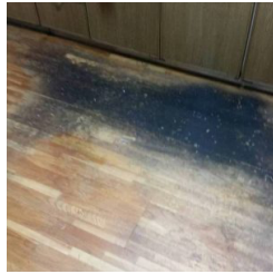
事務所/工場の床汚れ
